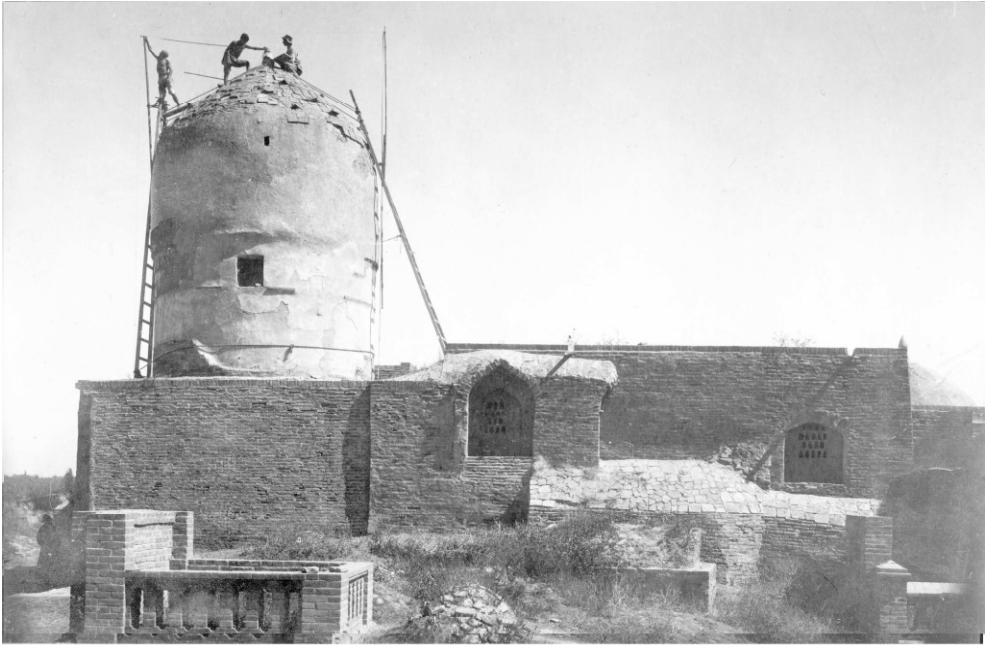
↑ Самарканд. Шах-и Зинда. Работы на мавзолее № 8. Туркестанская архитектурная экспедиция, 1921 г. Фото А. П. Удаленкова.
